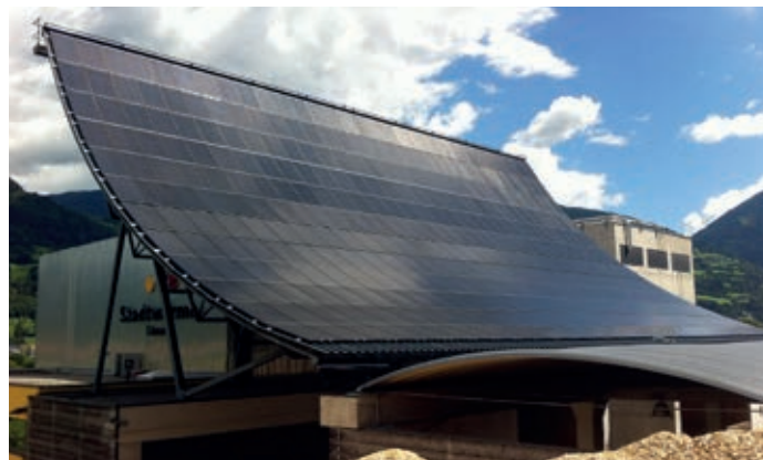
PV-Anlage Fernheizwerk Lienz
